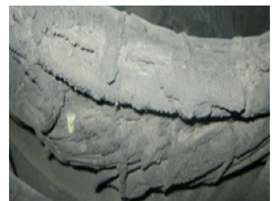
Encrassement typique d'un alternateur exploité en environnement industriel tropical (raffinerie d'huile de palme)
