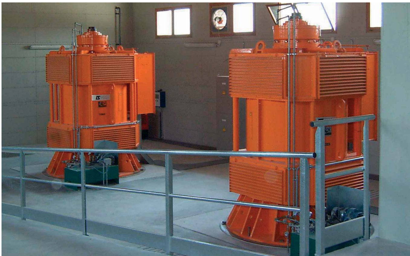
Vista Alternatori Leroy-Somer 5000 kVA
