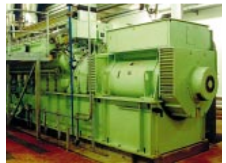
Italien - Nahrungsmittelindustrie. Blockheizkraftwerk für die Firma Inalca in Castelvetro bei Modena, bestehend aus einem Generator Leroy-Somer Typ LSA 54 L9 - 3.400 kVA - 1.000 min -1 - 3.300 V angekuppelt an einen Gasmotor Ulstein-Bergen.
