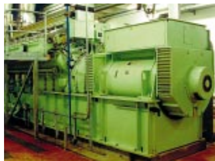
Italië - voedingsindustrie WKK-installatie voor de firma Inalca de Castelvetro in Modena met een Leroy-Somer generator type LSA 54L9 - 3400 KVA - 1000 t/min - 330 V gekoppeld aan een gasmotor van Ulstein-Bergen.
