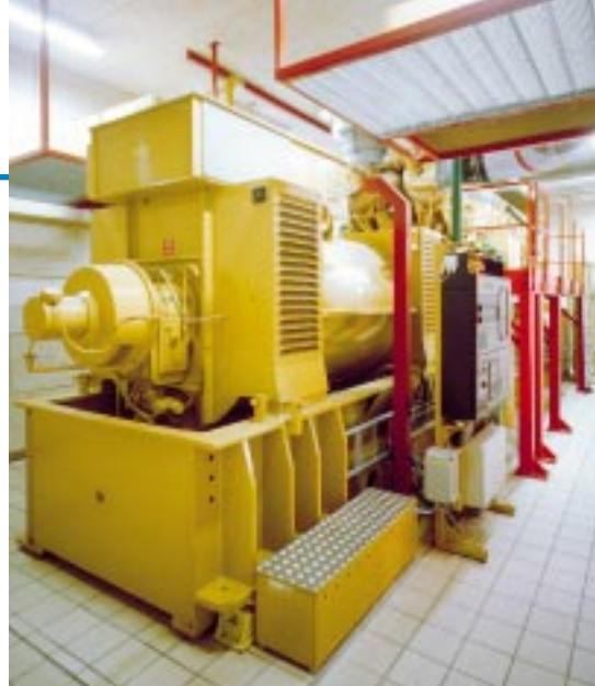
Denemarken - installatie in Hvide Sande in 1994-95 Groepenbouwer: Enmaco Motorer A/S – dealer Caterpillar Gasmotor type CAT G3616 SITA Generator type LSA 56 UL 95 / 6 polen / 3845 kWe / middenspanning / cos phi 0,9
