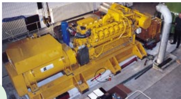
Nederland - WKK project in de polders. Twee gasmotoren drijven pompen aan. De warmte wordt gebruikt in het nabijgelegen industrieterrein. Wanneer er niet wordt gepompt, levert de generator elektriciteit die doorverkocht wordt aan de nationale leverancier.
