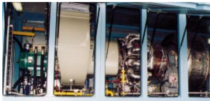
Frankrijk - chemische industrie. Turbogenerator genset (WKK) met een elektrisch vermogen van 6,8 MW. 4 MW worden gebruikt voor het productieproces, de rest wordt terug op het net gezet. Fabricant: Tuma Turbomach SA (Zwitserland)
