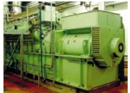
Italië - voedingsindustrie WKK-installatie voor de firma Inalca de Castelvetro in Modena met een Leroy-Somer generator type LSA 54L9 - 3400 KVA - 1000 t/min - 330 V gekoppeld aan een gasmotor van Ulstein-Bergen.
