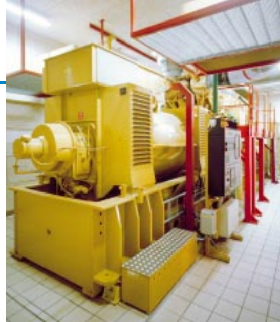
Denemarken - installatie in Hvide Sande in 1994-95 Groepenbouwer: Enmaco Motorer AVS – dealer Caterpillar Gasmotor type CAT G3616 SITA Generator type LSA 56 UL 95 / 6 polen / 3845 kWe / middenspanning / cos phi 0,9
