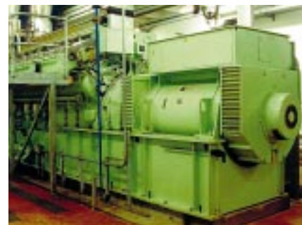
Italia - Industria alimentare. Impianto di cogenerazione della società Inalca di Castelvetro di Modena (Industria Alimentare Carni) realizzato con alternatore Leroy-Somer tipo LSA 54L9 - 3400 KVA - 1000 giri/Min-1 - 3300 Volt accoppiato a motore a gas Ulstein-Bergen.
