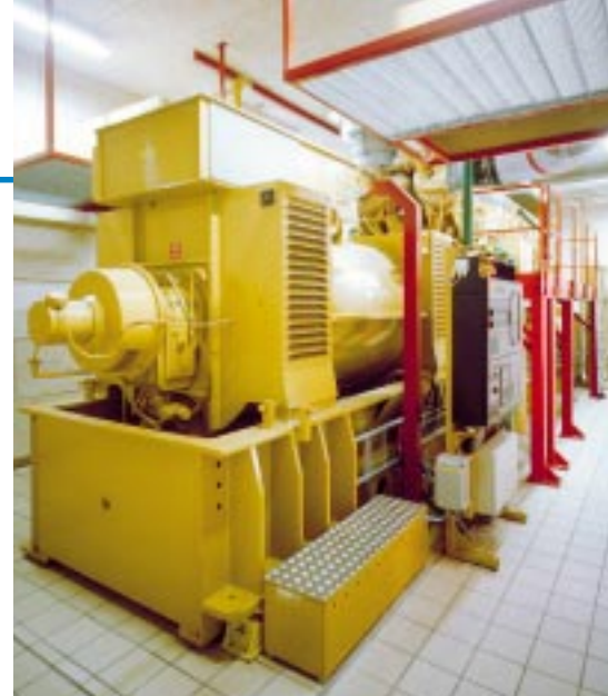
Danimarca - Impianto a Hvide Sande nel 1994-95. Costruttore del gruppo elettrogeno: Enmaco Motorer A/S - rivenditore CATERPILLAR. Motore a gas tipo CAT G3616 SITA. Alternatore tipo LSA 56 UL 95 / 6 poli/ 3845 kWe / media tensione/ Cos fi 0,9.
