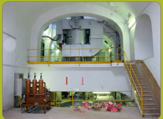
La centrale a lavori ultimati
