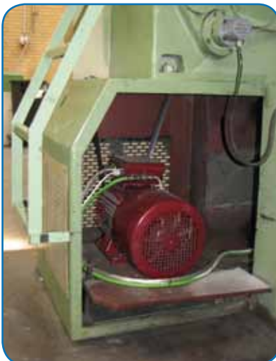
... wurde durch einen energieeffizienten LSRPM-Motor ersetzt.
