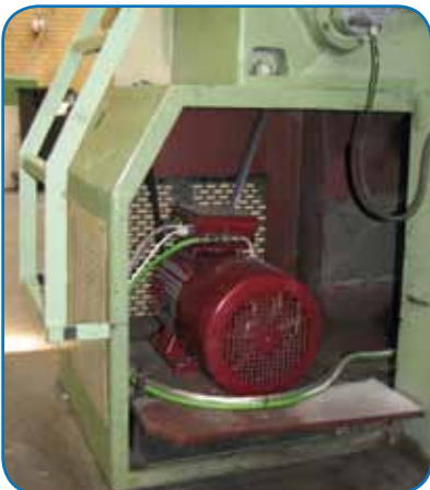
... a été remplacé par un moteur LSRPM à économie d'énergie.
