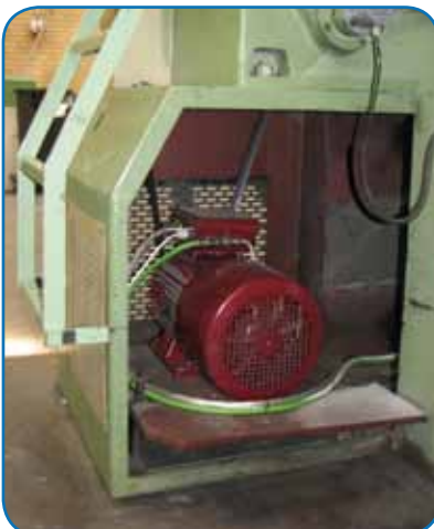
... wurde durch einen energieeffizienten LSRPM-Motor ersetzt.
