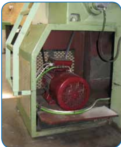
... werd vervangen door een energie-efficiënte LSRPM-motor.
