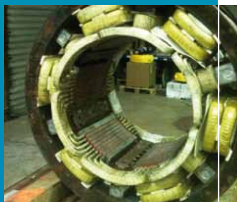
Rebobinage de la Carcasse d'un moteur DC de 150 kW - 600 tr - 440V
