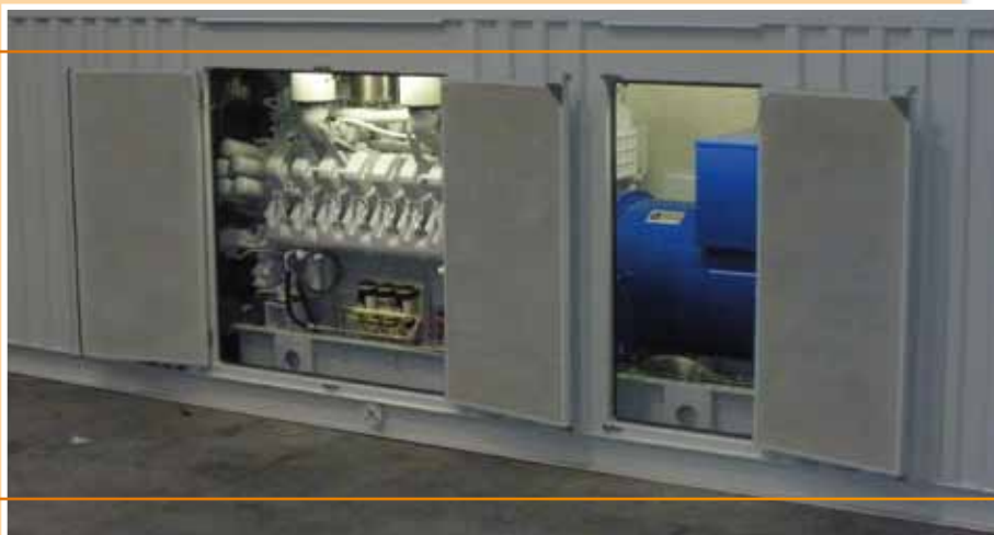
Groupe électrogène Diesel de secours installé dans une usine de traitement située à M'Boundi en République du Congo.
