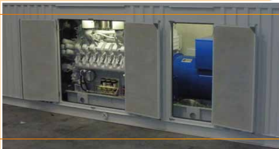
Mit Diesel betriebenes Notstromaggregat in einem Verarbeitungsbetrieb in M'Boundi in der Republik Kongo.
