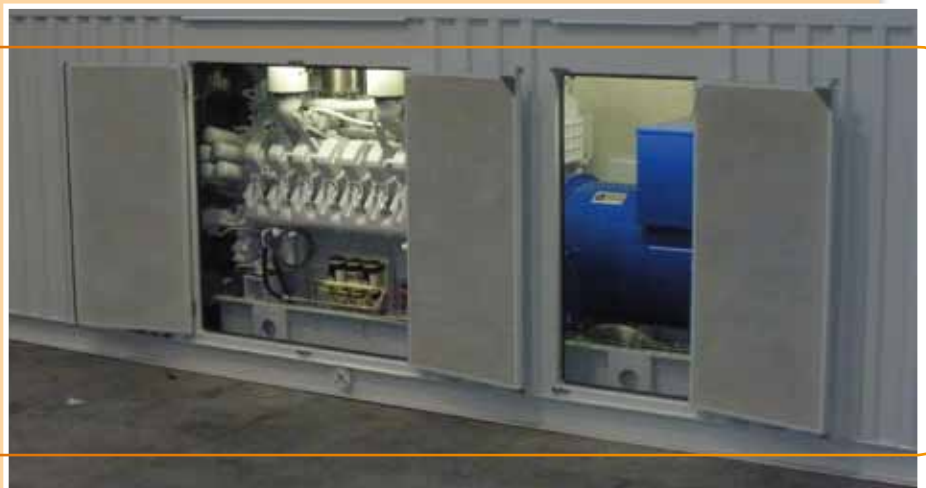
Dieselhulpgeneratorgroep geïnstalleerd in een verwerkingsbedrijf in M'Boundi in de Republiek Kongo.
