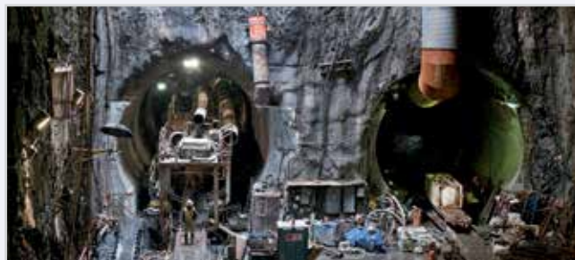
Foto af konstruktionen under det nuværende lave niveau af Grand Central Terminal, New York City. (Fotot tilhører Metropolitan Transportation Authority i staten New York / Patrick Cashin).
