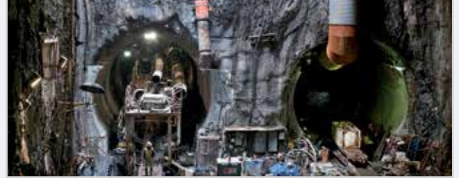
New York City'deki Grand Central Terminal'in mevcut seviyesi altındaki yapıdan görünüm. (New York Eyaleti Metro Ulaşım İdaresi (MTA) fotoğrafı / Patrick Cashin).
